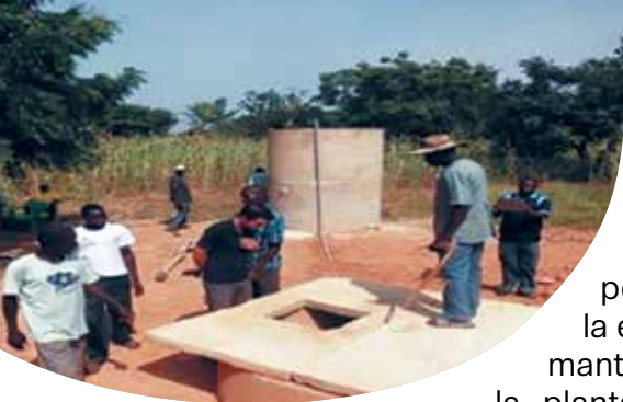
Figura 5. Pozos hortícolas con torre de agua para riego por goteo
